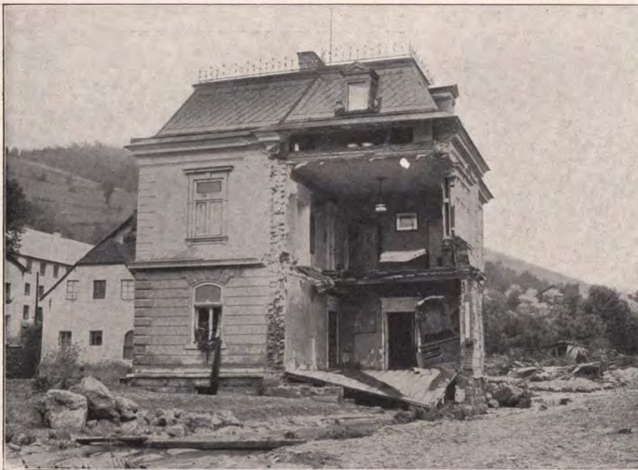
Start beschädigte Villa.
