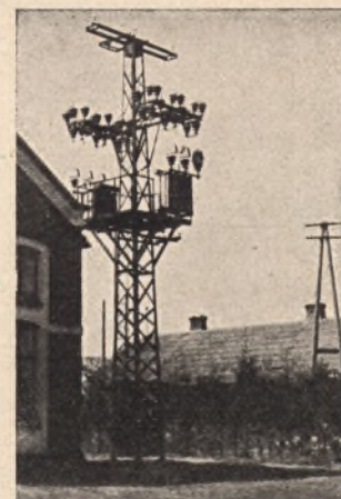
Stacja transformatorowa słupowa w Dublanach 30/0·4 KV 2×50 KVA
