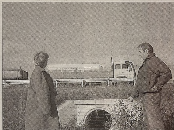
- Ten przepust pod autostradą umieszczony jest zbyt wysoko, woda z rowów do niego nie splywa, tylko rozlewa się dookoła - pokazują Jerzy Tomeczek i Elżbieta Banert.
