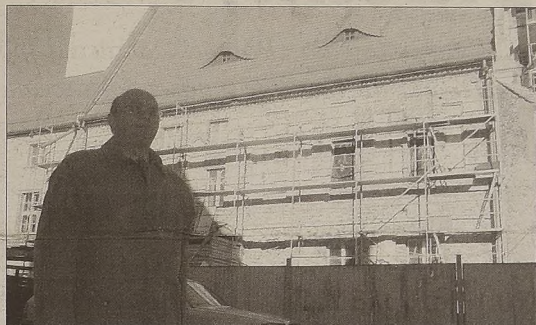
Odkryte blendy znajdują się na innym poziomie niż współczesne okna - mówi prezes Ochmański.
