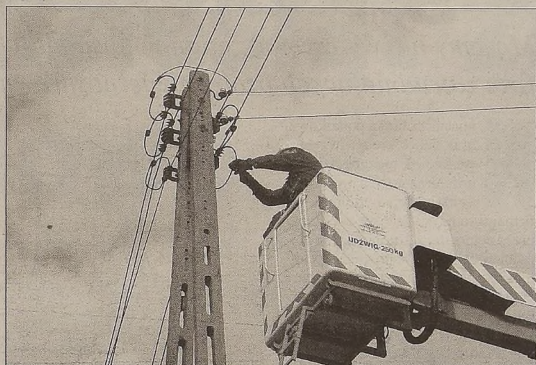
Po każdej kradzieży przewodów monterzy zakładu energetycznego mają pełne ręce roboty.
